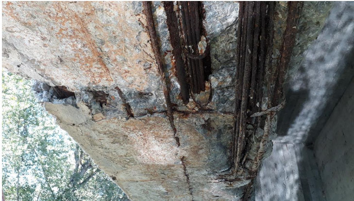
Εικόνα 9: Οξειδωμένοι σωλήνες περιβολής στο μέσο του ανοίγματος της γέφυρας
