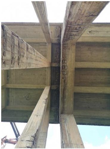
Εικόνα 2: Αρμός μεταξύ ακραίου και κεντρικού ανοίγματος και περιοχές αποφλοίωσης σκυροδέματος και έντονης οξείδωσης του οπλισμού
